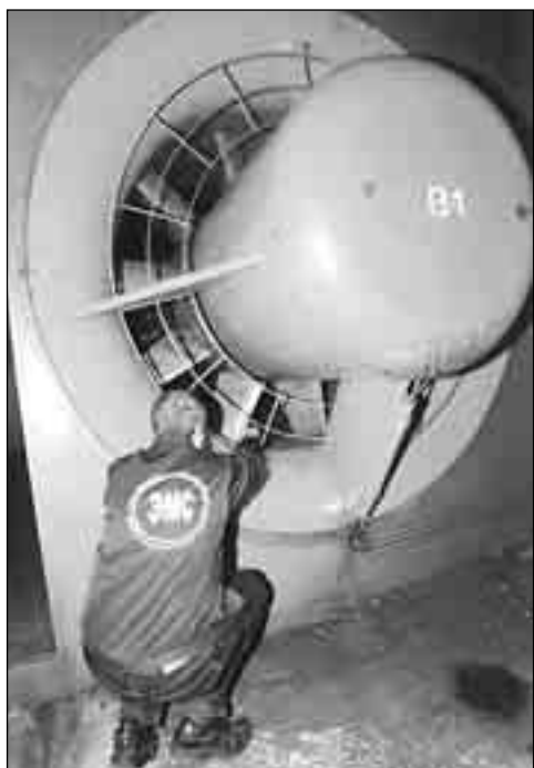
А это подземный вентилятор.
